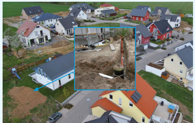
In Neubaugebieten, als Hausanschluss- oder Bauwasserzähler-Schacht
