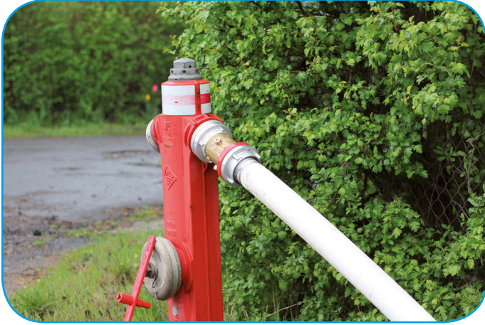
Feuerwehr-KMR am Oberflurhydranten
