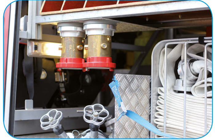
Montage des Feuerwehr-KMR im Löschfahrzeug
