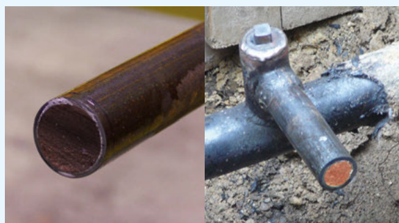
Der EWE-2K-Absperrschaum sitzt nach kurzer Aushärtung als gasdichter Pfropfen in der Anschlussleitung und trennt diese vom übrigen Rohrnetz.
